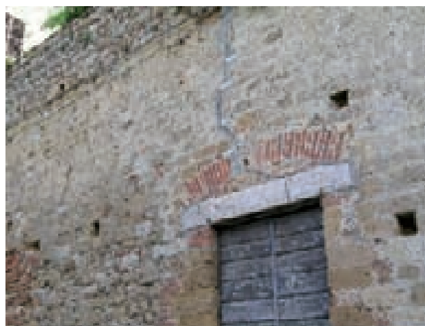
Fig. 13 - Lesioni sul muro del giardino pensile di Palazzo Piccolomini.
