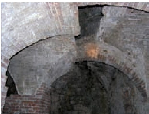
Fig. 12 - Lesione nella volta di una cantina sottostante il giardino pensile del Palazzo Piccolomini. In corrispondenza della lesione la volta è rigettata di circa 50 cm.
