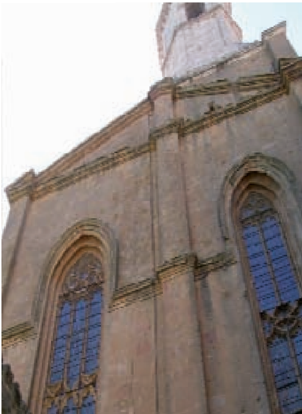
Fig. 3 - Una recente fessura apertasi sul lato sinistro dell'abside.
